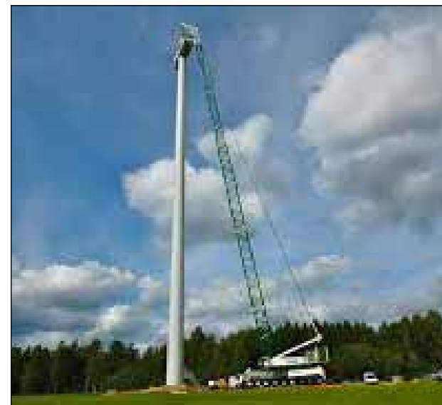
Figur 4.4 Opstilling af vindmølle med mobilkran, kilde: BMS.dk af gravemaskiner og lastbiler under etableringen.
